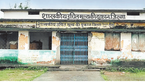
जर्जर पीडीएस भवन जहां से होता है खाद्यान्न का वितरण।
